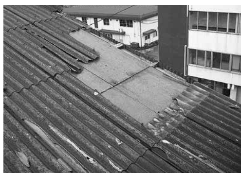
写真1 強風で飛散したスレート屋根
