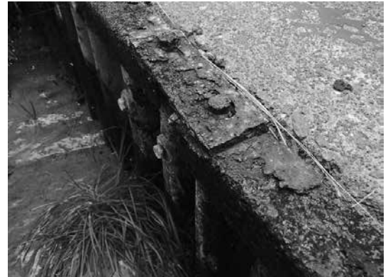
写真-31 水路工に付帯する鉄部の錆発生
