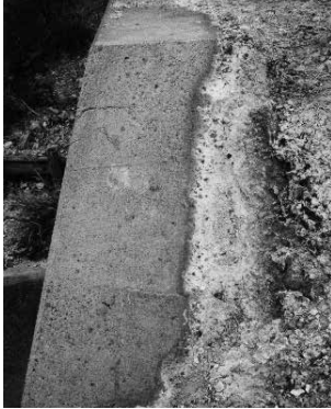
写真-12 温泉水劣化
