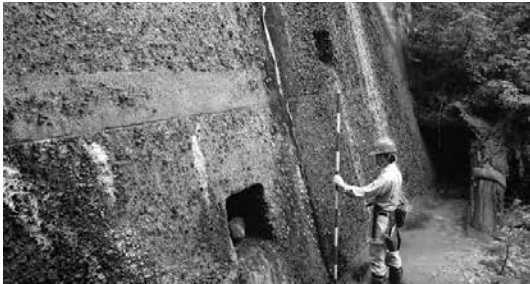
写真-13 コンクリート谷止の劣化
