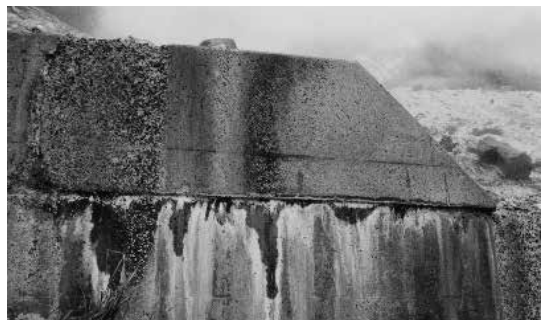
写真-10 温泉水劣化
