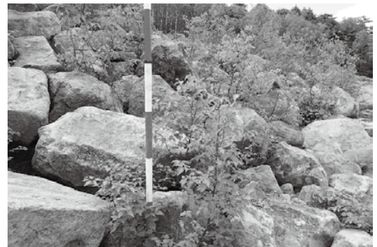
写真-36 自然石張り面に自然侵入したカンパ
