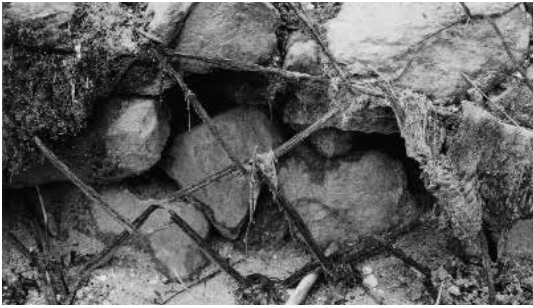
写真-11 火山ガス劣化
