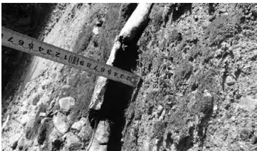
写真-14 コンクリート谷止の劣化
